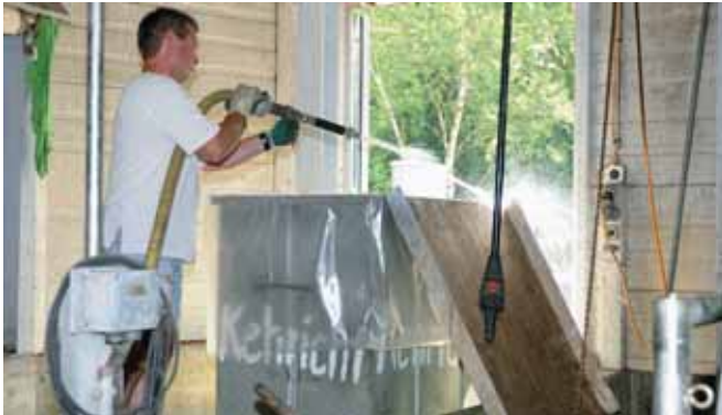
Reinigungsarbeiten sind äusserst wichtig in einer ARA.
